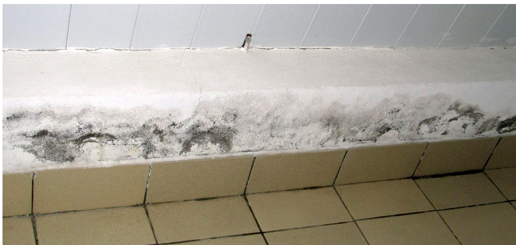
Рисунок 1.4а Пошкодження внутрішньої частини фундаменту АМК грибком
